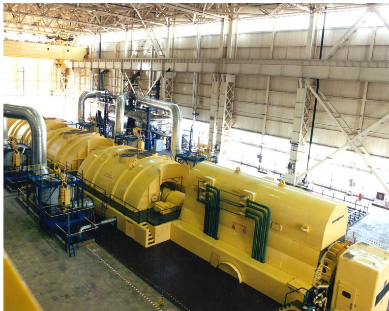
Vedere de Ansamblu Turbina - Generator
